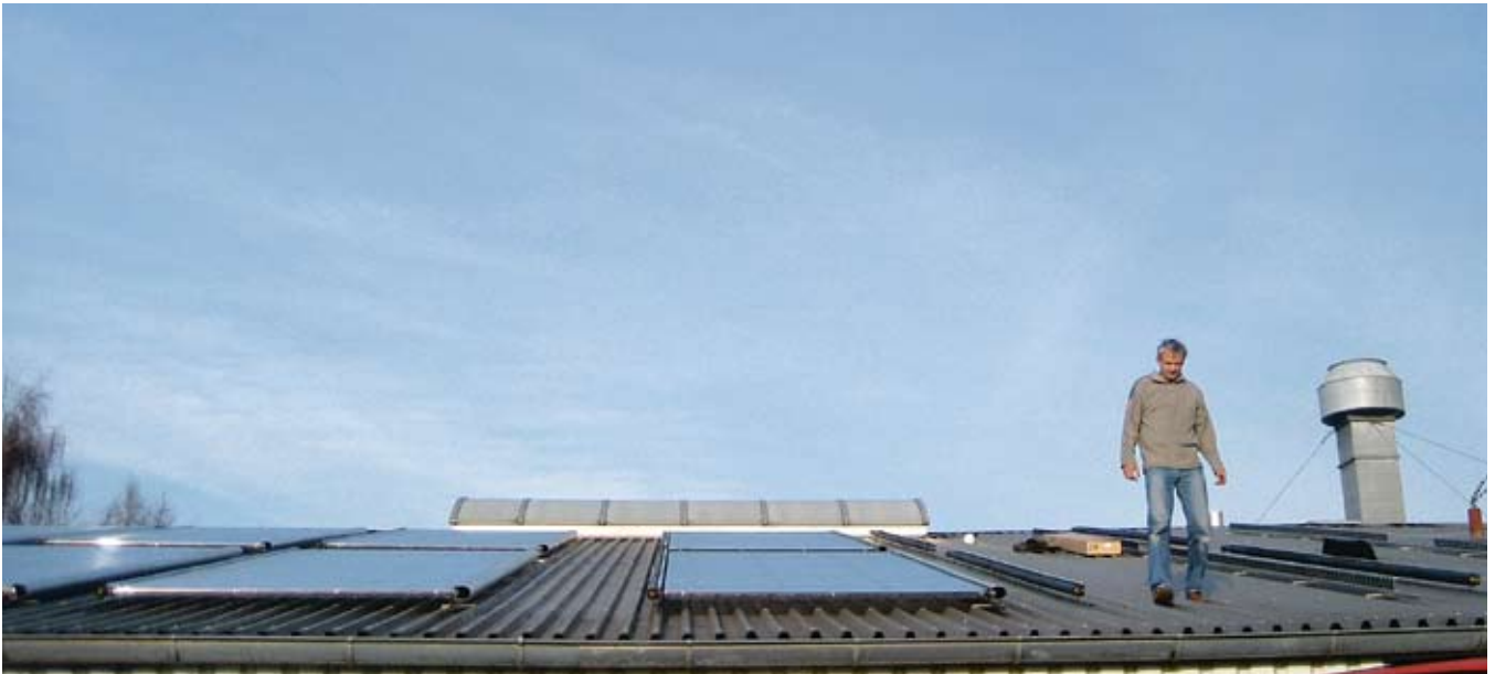
Zunächst befestigen die S-Power-Mitarbeiter die Montageschiene auf dem Hallendach. Dann setzen sie die Vakuumröhren einzeln ein.
